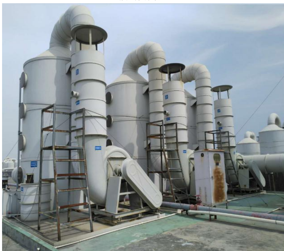
废气处理设施
