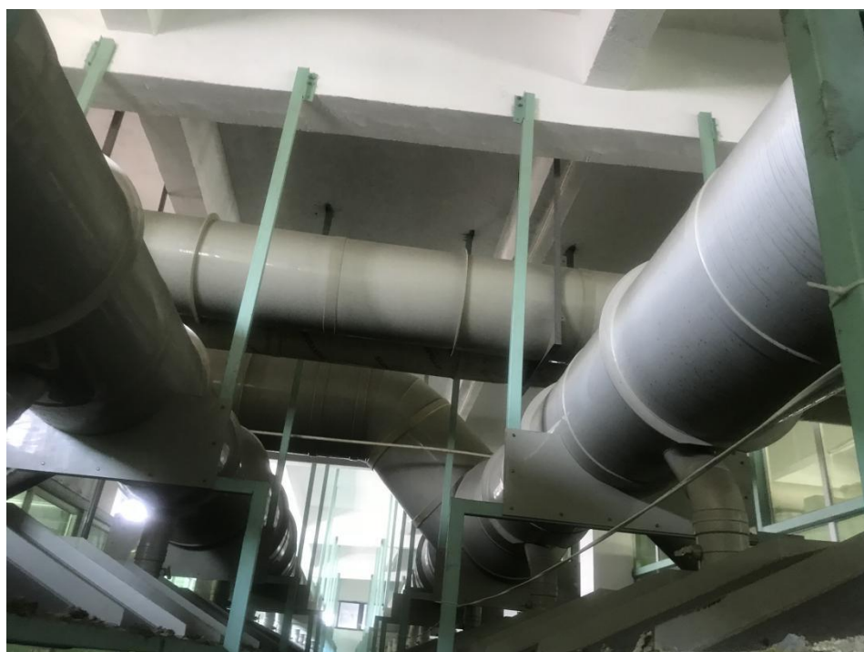
废气收集管道
